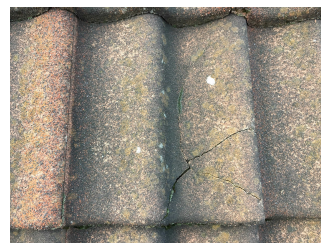
Sprukken takstein midt på taket.
