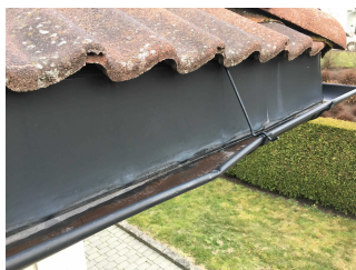
Skade på takrenne.
